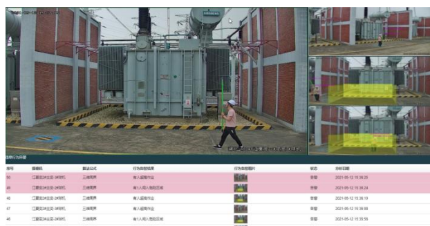
变电站场景三维区域管控
